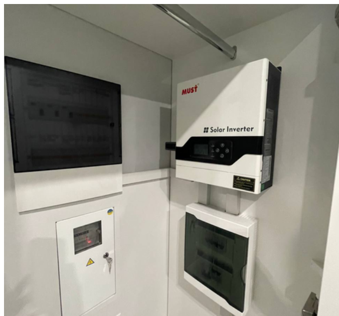
м. Крижопіль, 5 кВт гібридна СЕС з АКБ на 4,8кВт
