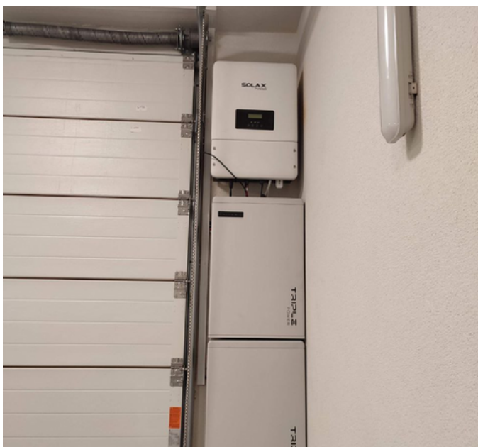
с. Свидівок, 10 кВт гібридна СЕС з АКБ на 10 кВт
