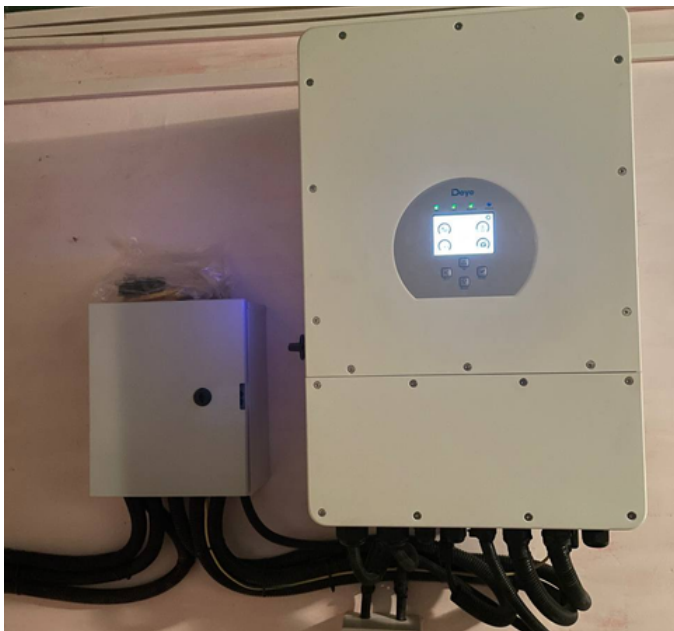
с. Бубнівська Слобідка, 12 кВт гібридна СЕС з АКБ на 5 кВт
