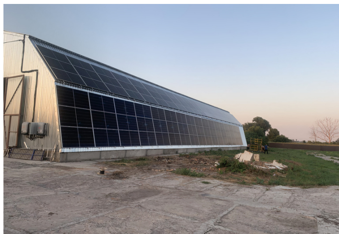
с. Нова Дмитрівка, станція потужністю 81 кВт та ємністю по АКБ 245,76 кВт, Тваринна ферма
