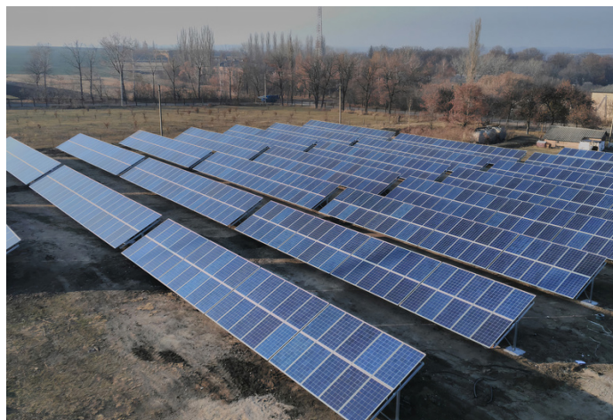
Запорізька область, станція потужністю 600 кВт, Фермерське господарство
