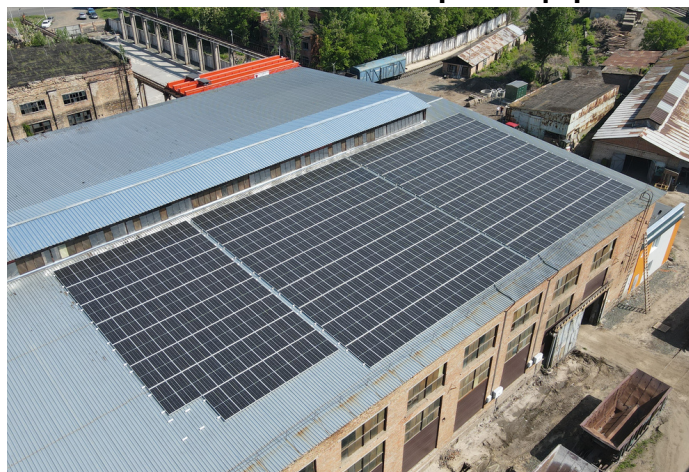
м. Сміла, станція потужністю 200 кВт Вагоноремонтний завод
