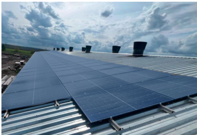
Київська область, станція потужністю 240 кВт під власне споживання та Net Billing
