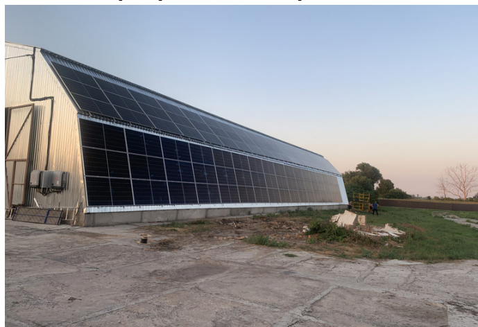
с.Нова Дмитрівка. Станція потужністю 81 кВт та ємністю по АКБ 245,76 кВт. Тваринна ферма
