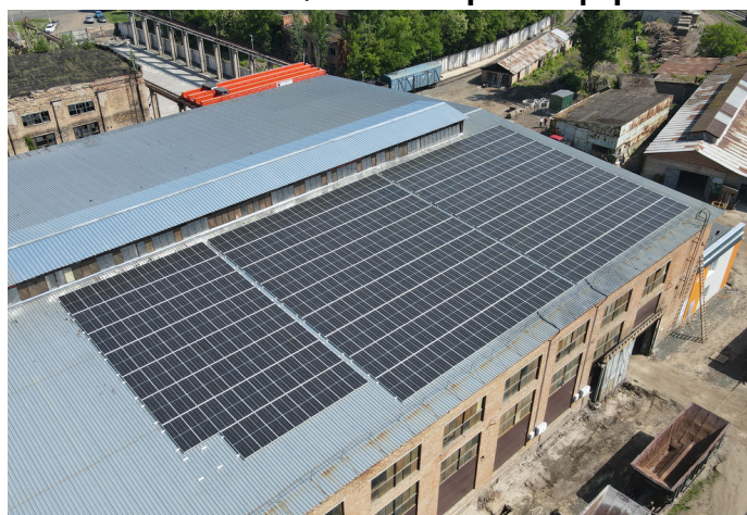
м. Сміла, станція потужністю 200 кВт. Вагоноремонтний завод
