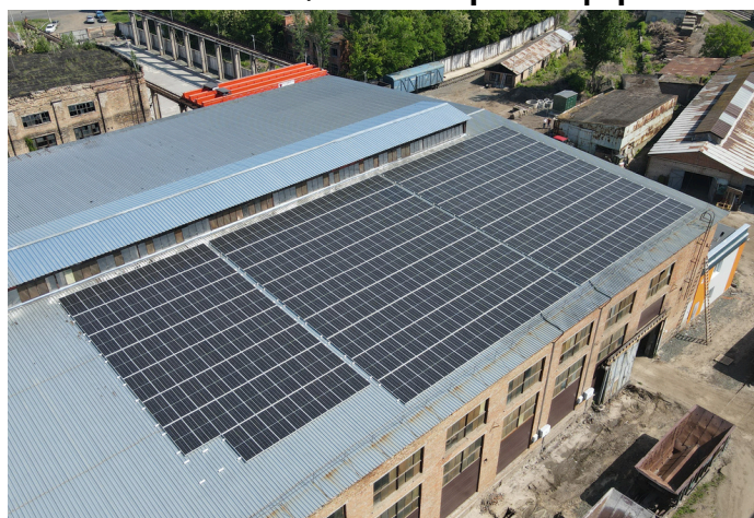
м. Сміла, станція потужністю 200 кВт. Вагоноремонтний завод
