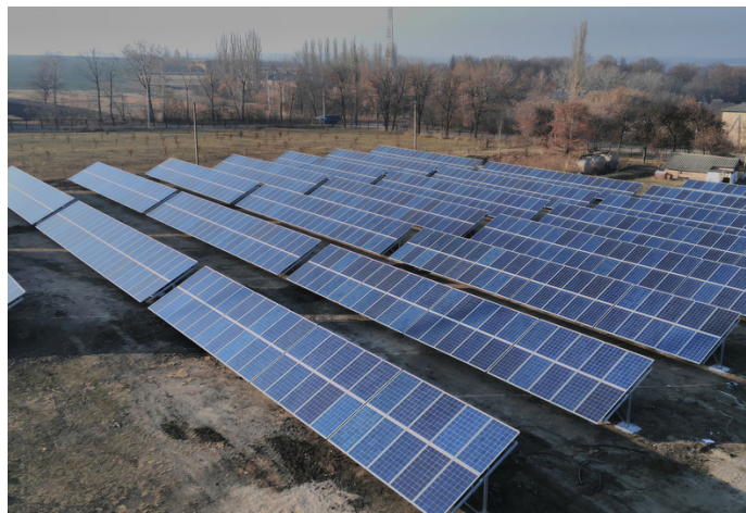
Запорізька обл. Станція потужністю 600 кВт Фермерське господарство
