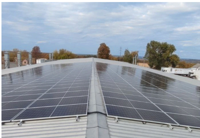
Черкаська обл. Станція потужністю 179,82 кВт. Розведення свійської птиці
