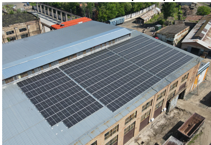
м. Сміла, станція потужністю 200 кВт. Вагоноремонтний завод
