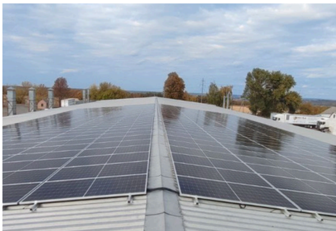
Черкаська обл. Станція потужністю 179,82 кВт. Розведення свійської птиці
