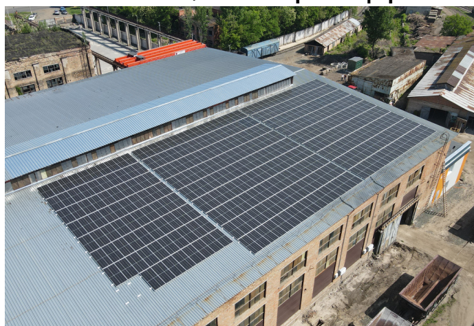
м. Сміла, станція потужністю 200 кВт. Вагоноремонтний завод
