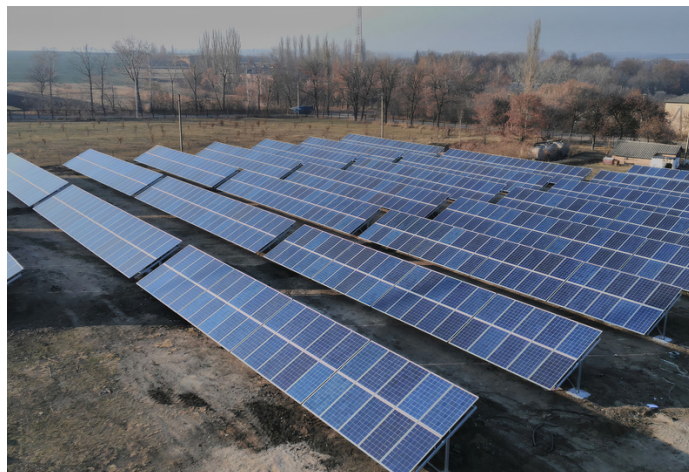
Запорізька обл. Станція потужністю 600 кВт Фермерське господарство
