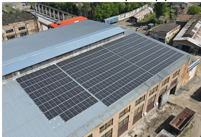
м. Сміла, станція потужністю 200 кВт. Вагоноремонтний завод
