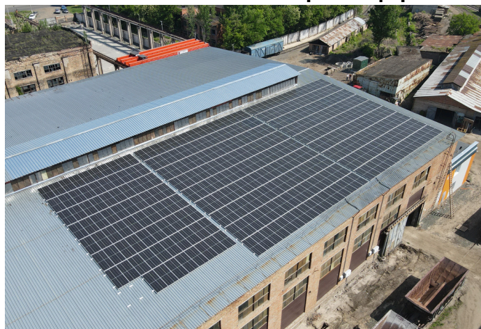
м. Сміла, станція потужністю 200 кВт Вагоноремонтний завод
