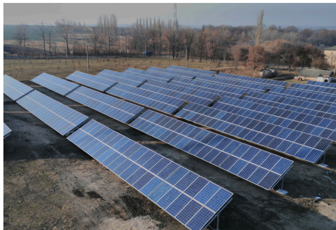
Запорізька область, станція потужністю 600 кВт, Фермерське господарство
